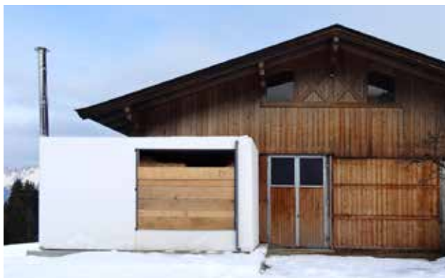
Module de chauffage à un étage 35 kW bois déchiqueté, exploitation agricole
