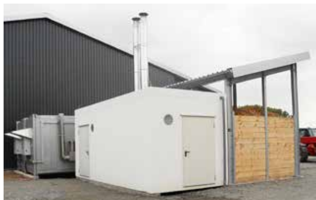
Module de chauffage à un étage 2 x 100 kW bois déchiqueté, commerce
