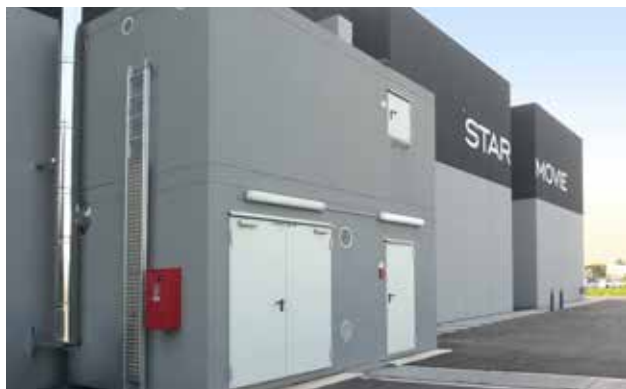
Module de chauffage double 200 kW bois déchiqueté, commerce
